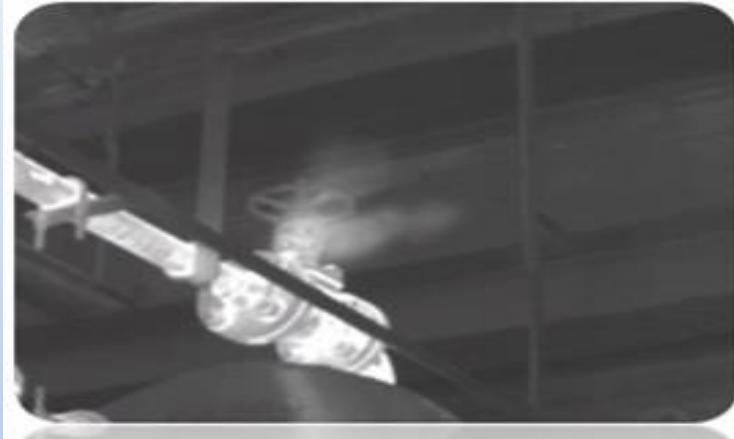
Fuite de gaz
